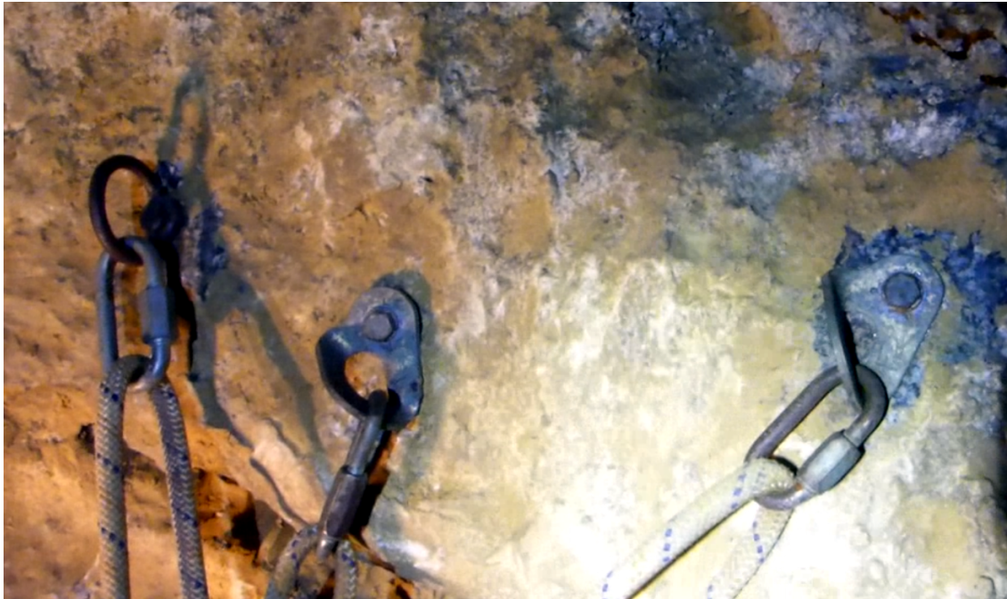
Anclajes viejos y oxidados en la cabecera del pozo de 45m (#4)
